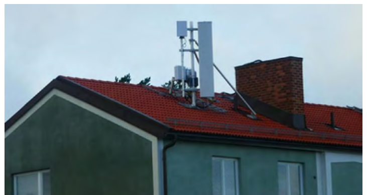
Figure 2 Station de base 5G sur le toit d'un immeuble de trois étages situé à 60 mètres de l'appartement étudié.
